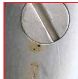
Exemple de corrosion par piqûres
