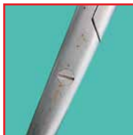
Exemple de corrosion par piqûres
