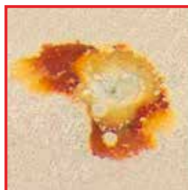
Exemple de corrosion par piqûres
