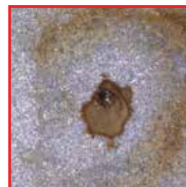
Exemple de corrosion par piqûres
